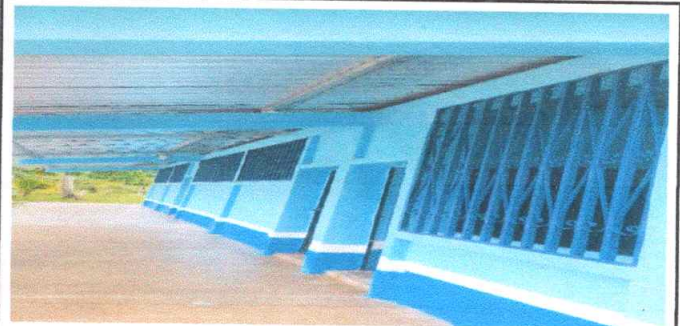
Foto 2: En esta fotografía evidencia el cambio de balcones.
